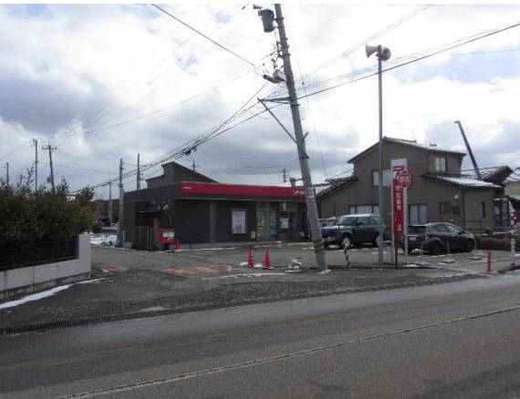
写真-7 内灘郵便局付近 建屋の沈下
