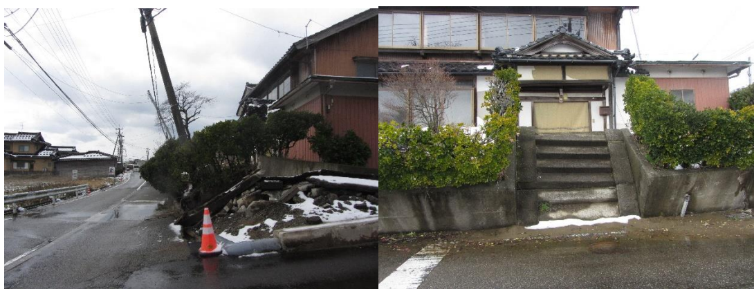
写真-2 県道8号線と162号線の西荒屋交差点での傾いた家屋
