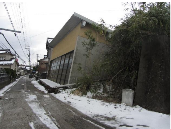
写真-5 傾いた建屋
